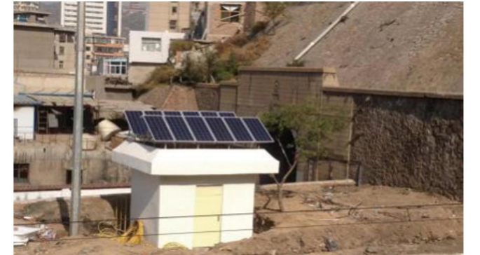
兰州局隧道铁路信号系统太阳能电源
