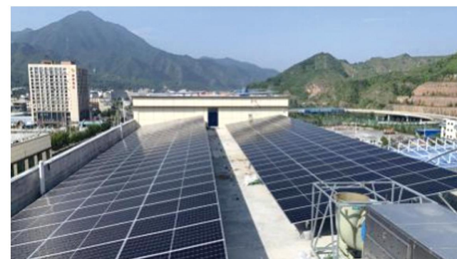
山阳疾控中心 410kw 屋顶光伏发电项目
