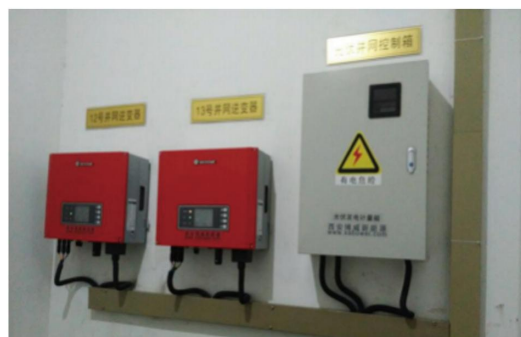
省政府明园小区屋顶光伏离网改并网项目
