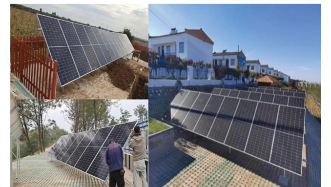
黄陵乡镇垃圾压缩站污水站太阳能电源
