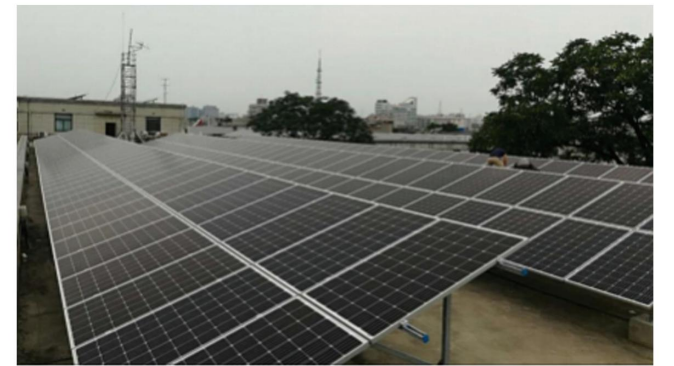
莲湖区政府 160kw 屋顶光伏并网发电节能示范项目
