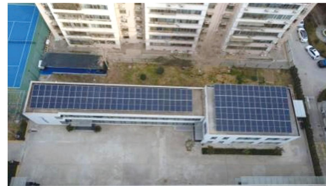
民航西北管理局服务中心屋顶光伏发电项目
