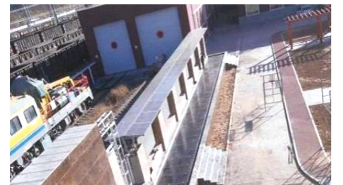
神朔铁路通信段光伏离网电站
