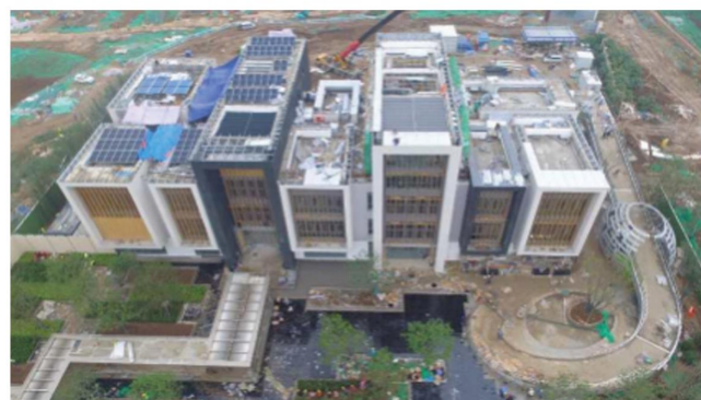
西安高新地产超低能耗建筑天谷雅舍光伏发电
