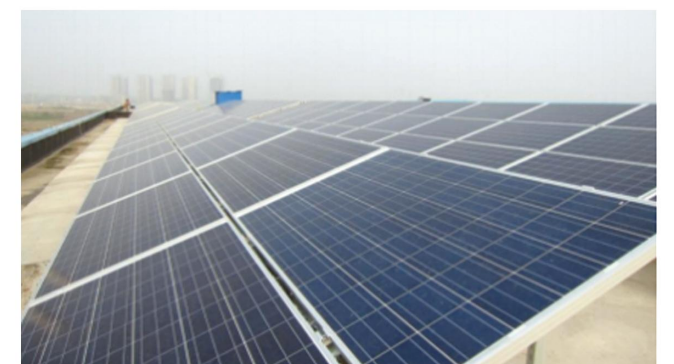
平高集团厂房办公楼屋顶光伏并网发电项目（企业园区）
