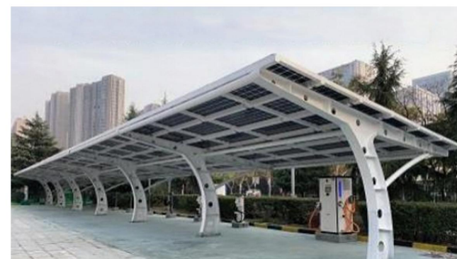
智能光伏车棚项目（西电凤城十一路园区光储充）
