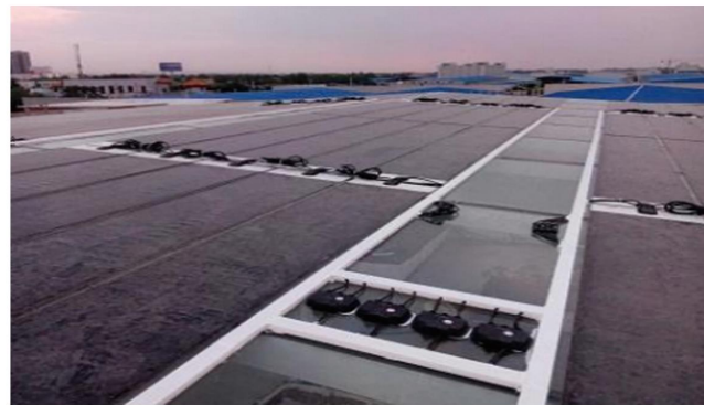
咸阳市三原柔性薄膜光伏阳光屋顶项目
