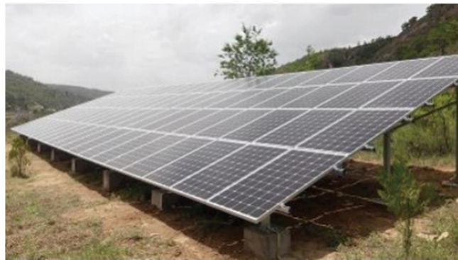
延安市志丹县光伏并网发电项目
