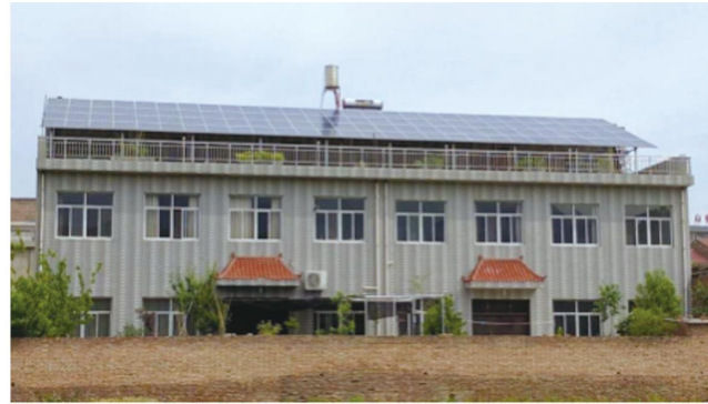
蓝田县玉山镇光伏并网发电项目
