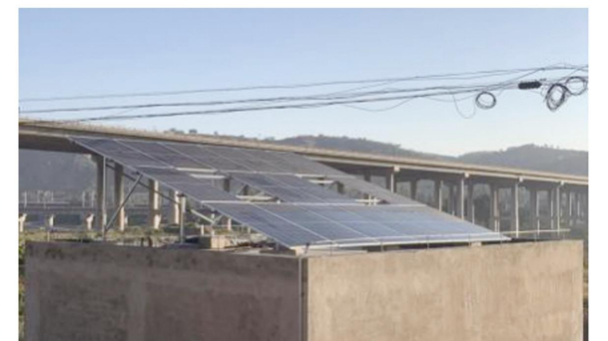
陕煤输煤管道阀室太阳能电源（多点位）
