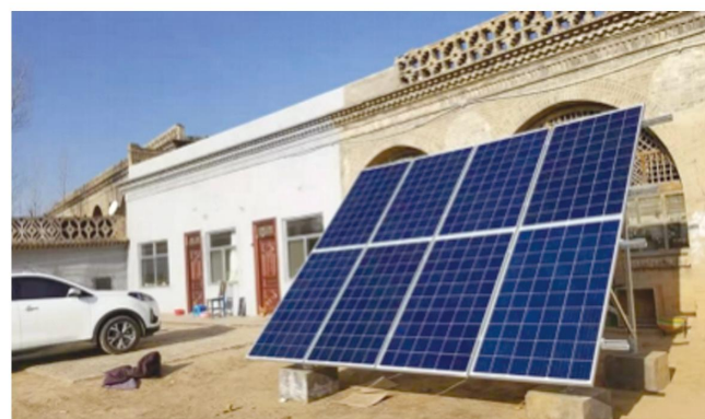
陕北住宅光伏离网电站
