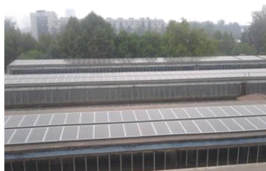
黄河集团厂房屋顶光伏并网发电项目
