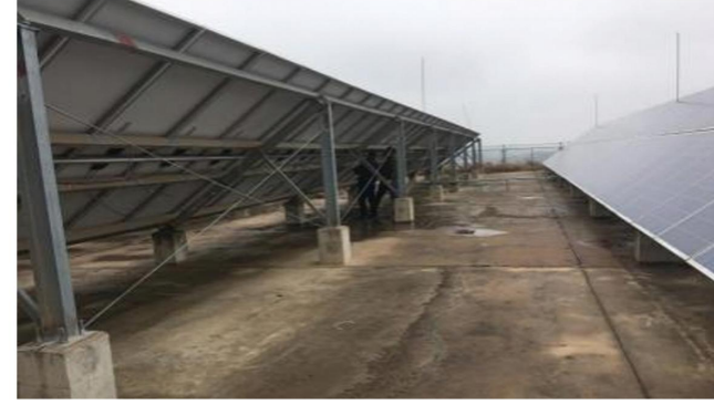
安塞 200kw 微网改并网项目
