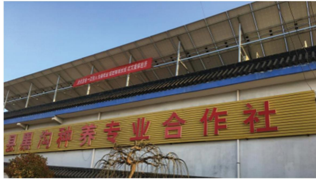
蓝田县黑沟村 200KW 光伏电站（7 个站）
