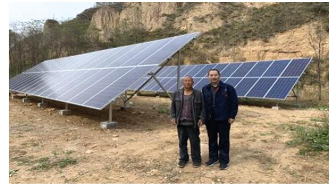
光伏水泵应用-淳化光伏提水灌溉系统
