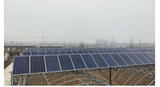
杨凌示范农业光伏大棚项目
