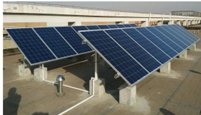
西安电子科技大学教学科研光伏发电项目
