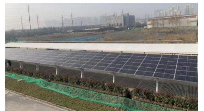
智能光伏车棚项目（西电西三环园区光储充）
