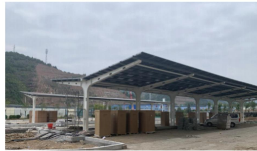
山阳充电站光伏车棚项目
