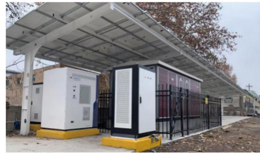
新城区域开公司太华路充电站光伏车棚项目
