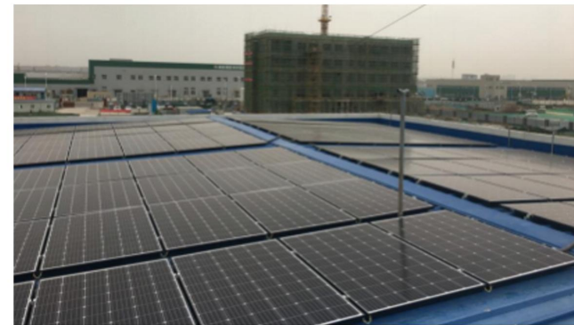
燃气集团新兴分布式园区屋顶光伏并网发电项目
