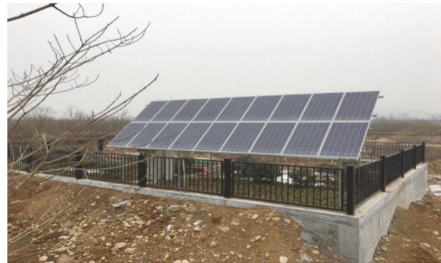
村镇污水处理站太阳能发电（离网/并网）
