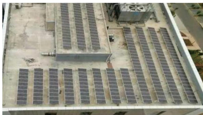
南宁轨道交通办公楼屋顶光伏并网发电项目
