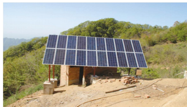
寺庙（秦岭堰青庙）风光互补离网电站项目
