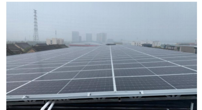
陕西新宝磁性材料厂房屋顶光伏发电项目
