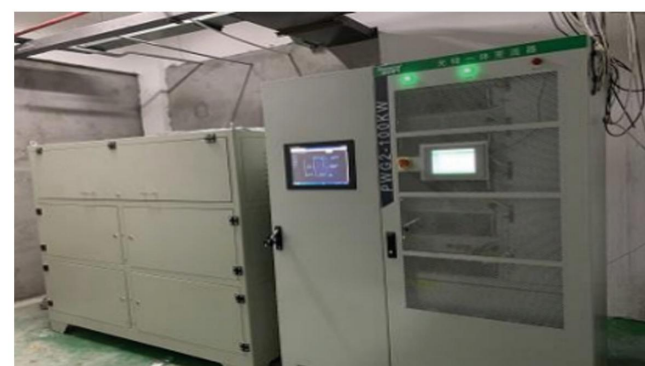
沔西 100kw 光伏微网（光伏储能一体化）
