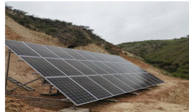
油气管道加热太阳能电源
