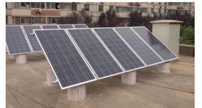
西安市燃气流量监测系统太阳能电源
