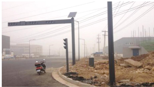
市政道路交通信号灯太阳能发电（高新区草堂）
