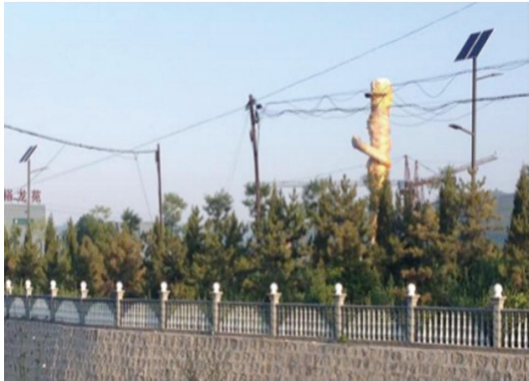
延安市黄龙县城道路太阳能路灯
