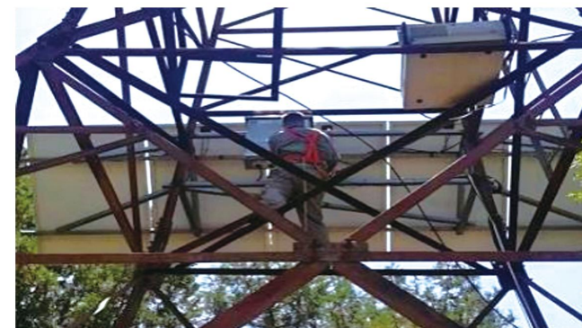
延安应急通信光伏电源
