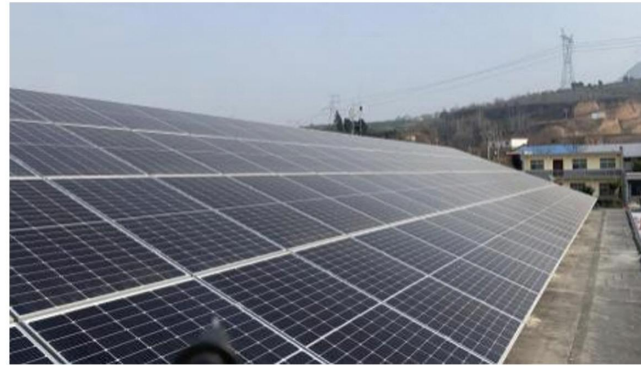
蓝田县薛家村 70KW 光伏电站
